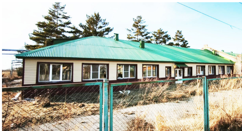
На фото: "отремонтированный" детский сад в пос. Николаевка стоит несколько лет как памятник разрухе
